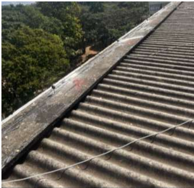
TELHADO SEM TRATAMENTO
